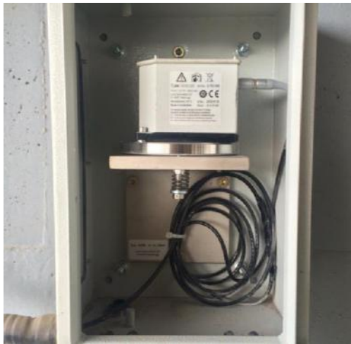
Геотехнический датчик (инклинометр)
